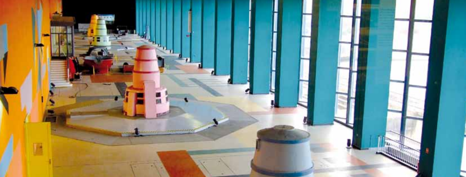
La salle des machines de la centrale de Vogelgrun, telle qu'on peut la découvrir depuis la passerelle panoramique de visite.
